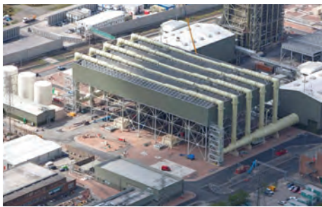
evern , Великобритания — Конденсатор с воздушным охлаждением для парогазовой установки мощностью 2x400 МВт.
