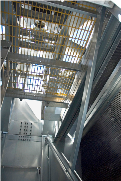
机械设备检修平台
