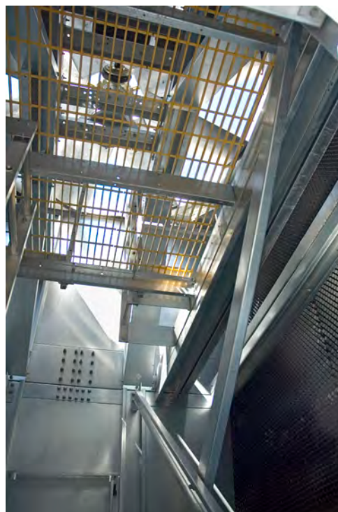
Zugangsplattform zu Internen Mechanischen
