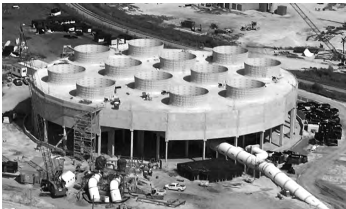
Рисунок 5 Градирни с несколькими вентиляторами с общим проходом
