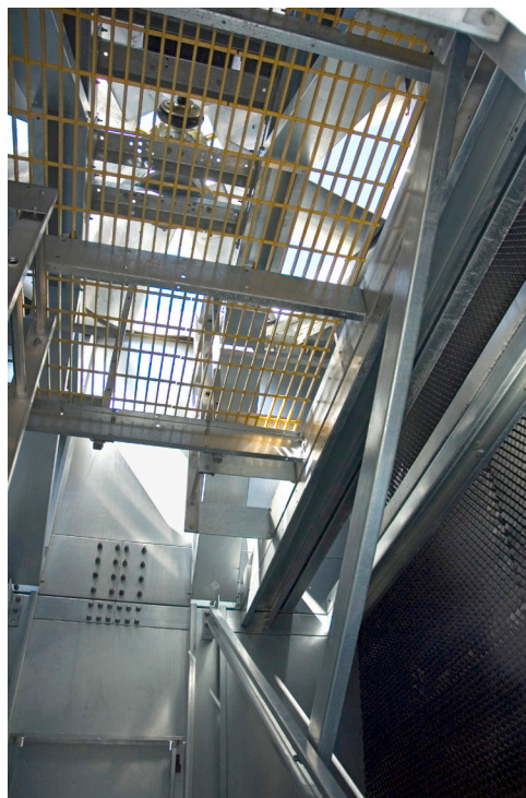
Plataforma de acceso del equipo mecánico
